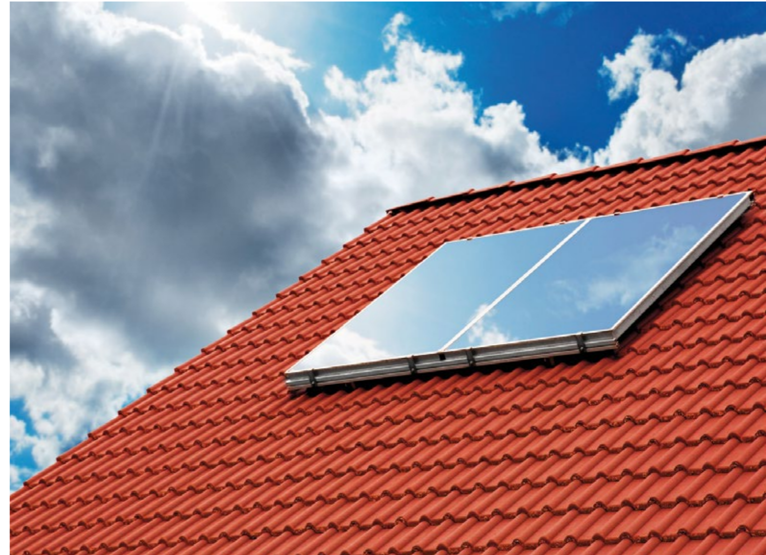
Durch solarthermische Anlagen kann der Warmwasserbedarf im Sommer nahezu vollständig gedeckt werden.
